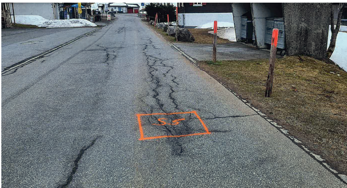
Bild 2: Allgemeinzustand der Strasse
