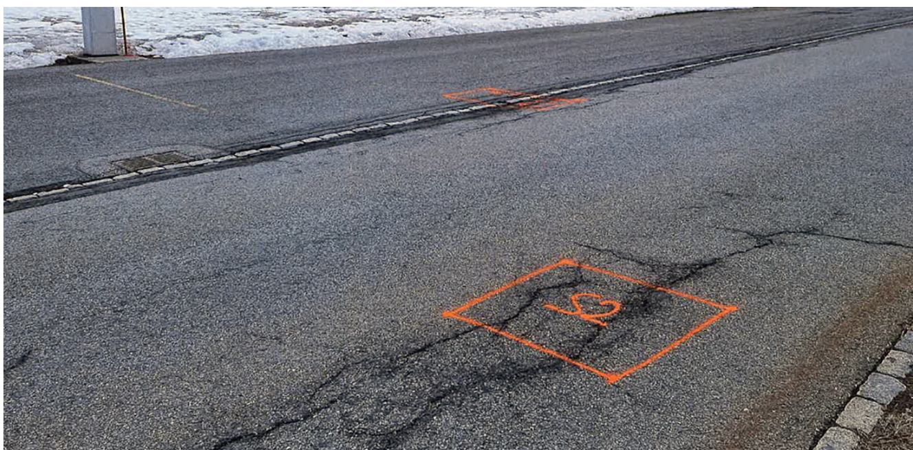
Bild 1: Allgemeinzustand der Strasse
